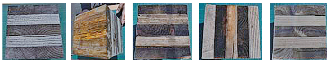
写真-2 地盤環境・亜寒帯（旭川）試験体の劣化状況の例
