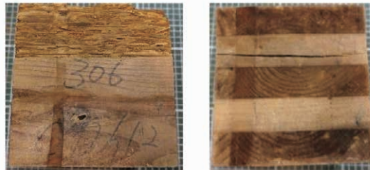
写真-13 劣化状況の例（土壌中・三次）
