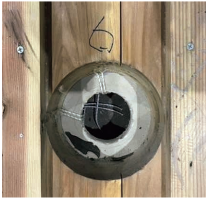
写真-15 解体時の設備貫通部の例 (試験体①仕様 6/CLT炭化なし)
