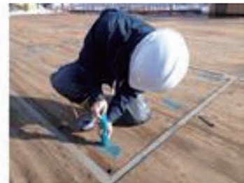
写真-27 腐朽度測定
