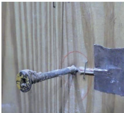
写真-17 解体時の留め具の例 (試験体①仕様 23/がたつきなし)
