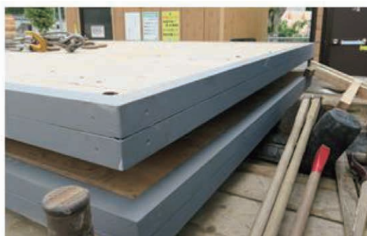
写真-22 端部保護フレーム
