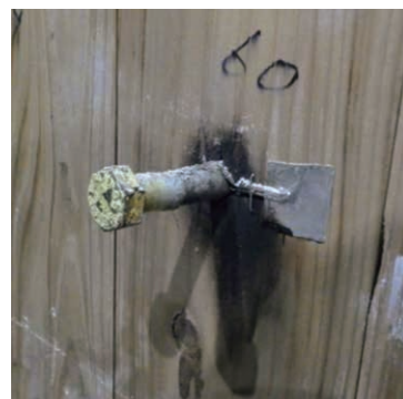
写真-18 解体時の留め具の例 (試験体①仕様 10/がたつきあり)
