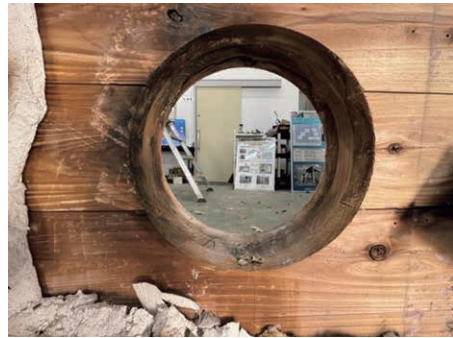
写真-16 解体時の設備貫通部の例 (試験体③仕様 2/CLT炭化なし)
