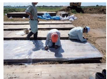
(c) 亀裂のスケッチ状況
